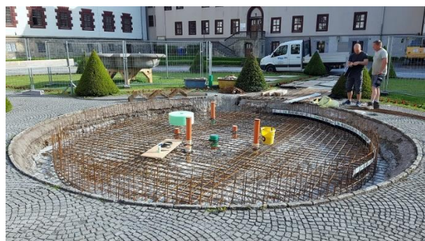
Nach der vollständigen Demontage des Brunnens wurde das Bassin abgedichtet und eine Bewehrung eingebaut.
