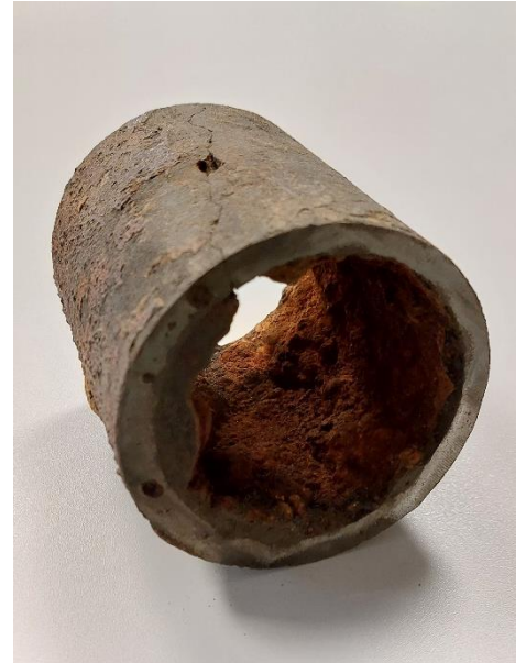
ausgebaute Schadstelle Foto: Stadtwerke Meiningen GmbH
