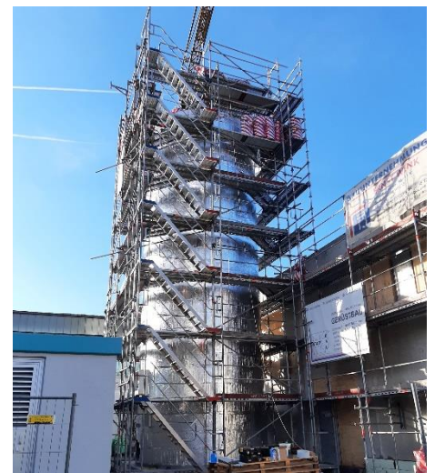
HKW Steinweg, Pufferspeicher Foto: Stadtwerke Meiningen GmbH
