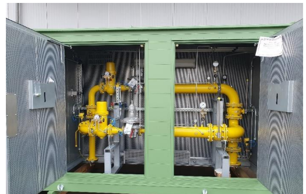
Ortsnetzregelanlage Marktwasserweg, Ansicht Regelschienen Foto: Stadtwerke Meiningen GmbH
