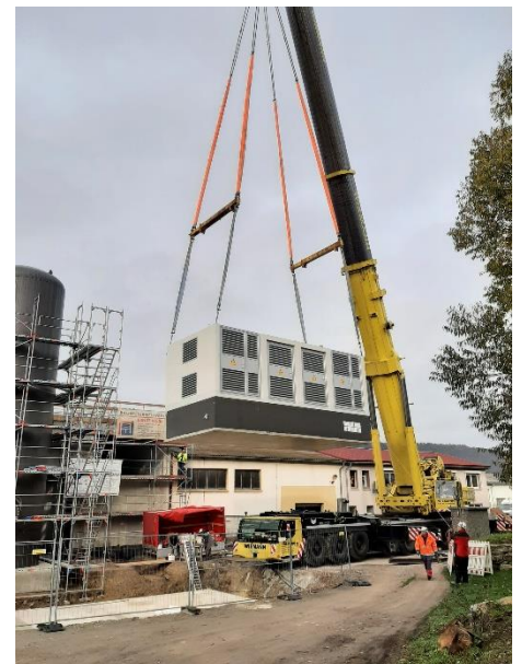
Schutzstation „Süd“ Foto: Stadtwerke Meiningen GmbH
