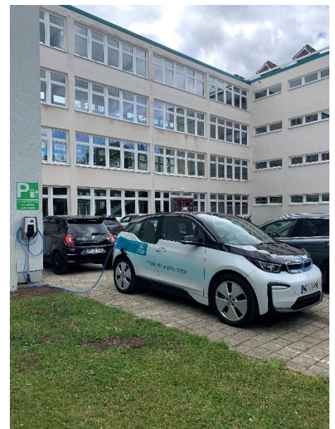
Ladesäule am Henfling-Gymnasium Foto: Stadtwerke Meiningen GmbH
