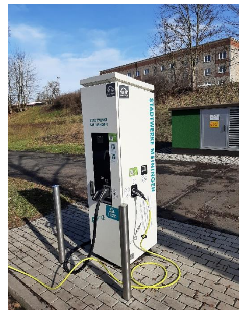
Schnellladesäule Lindenallee Foto: Stadtwerke Meiningen GmbH
